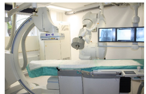
Installation eines TX 200 Hochleistungs-6-Arm-Roboters der Firma Stäubli im Tier-OP von SEON für die präzise Steuerung und Positionierung des Magnetfeldes.
